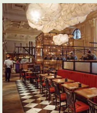
Restauracja Burger & Lobster. Bath, Wielka Brytania. Pompa ciepła powietrze-woda Aquarea została zainstalowana w nowo otwartej luksusowej restauracji Burger & Lobster w Bath. Octagon Chapel, duży zabytkowy budynek w centrum miasta, został przerobiony na restaurację, a system Aquarea firmy Panasonic zapewnił wszechstronne, energooszczędne i dyskretne rozwiązanie w zakresie ogrzewania i chłodzenia.
